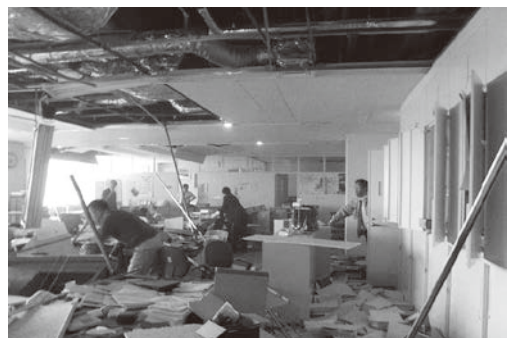
地震により損壊した執務室
